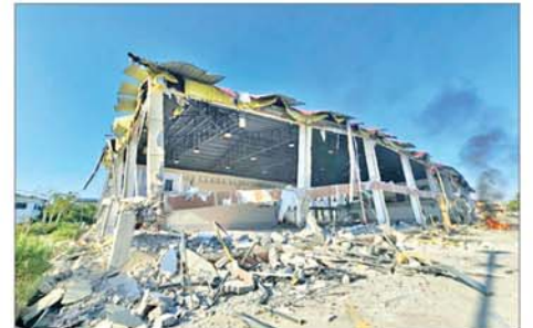
မြဝတီမြို့၌ အဆောက်အအုံ ဖြိုချဖျက်ဆီးမှုကို တွေ့ရစဉ်။
