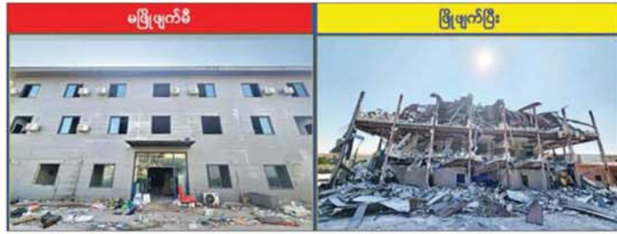
KK Park နယ်မြေအပိုင်း(၃)တွင် တရားမဝင် ဆောက်လုပ်ထားသည့် သုံးထပ် လူနေအဆောက်အအုံ မဖြိုဖျက်မီနှင့် ဖြိုဖျက်ပြီးပုံ။
