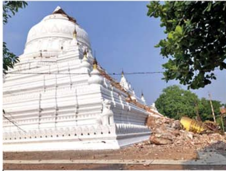
ငလျင်ခတ်ကြောင့် ထိခိုက်ခဲ့ရသော ပုထိုးတော်ကြီးပုံ။
