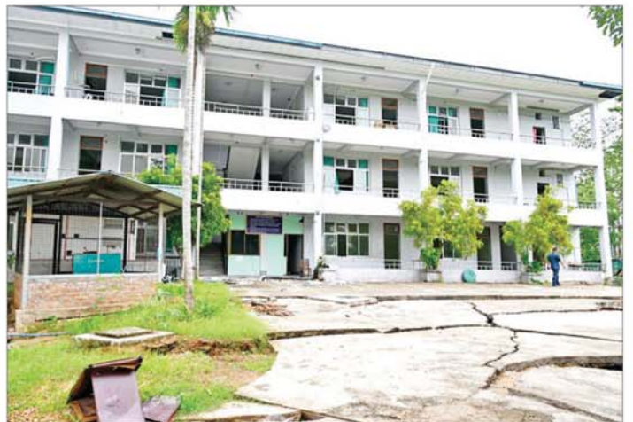
အလုပ်သမားဝန်ကြီးဌာနရုံးအဆောက်အအုံ ငလျင်ဒဏ်ကြောင့် ထိခိုက်ပျက်စီးခဲ့မှု မှတ်တမ်းဓာတ်ပုံ။
