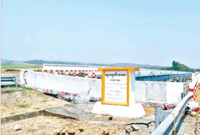
ငလျင်ဒဏ်ကြောင့် ဆွာချောင်းတံတား ထိခိုက်ပျက်စီးမှုအခြေအနေကို တွေ့ရစဉ်။
